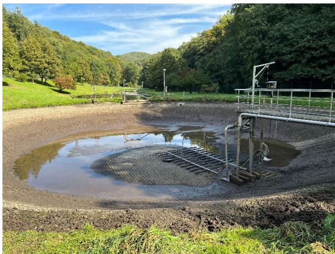
Lufteintrag über alte Kerzenbelüfter
