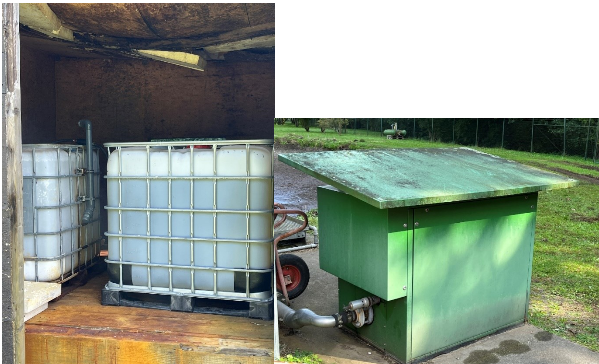
alte Fällmitteldosieranlage (IBC-Container in provisorischer Holz-Einhausung)
