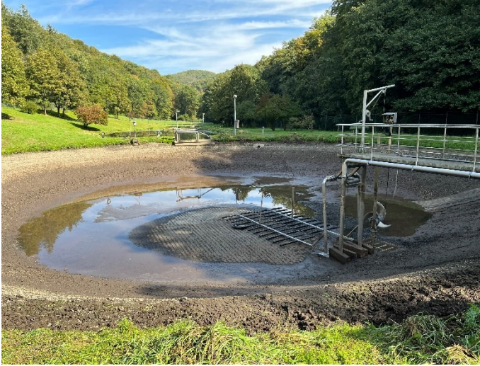
Luft eintrag über alte Kerzenbelüfter
